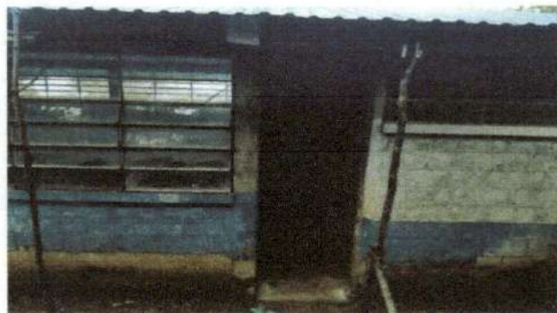
Foto 2: Se Observa deterioro de las puertas y la necesidad de sustituirlas
